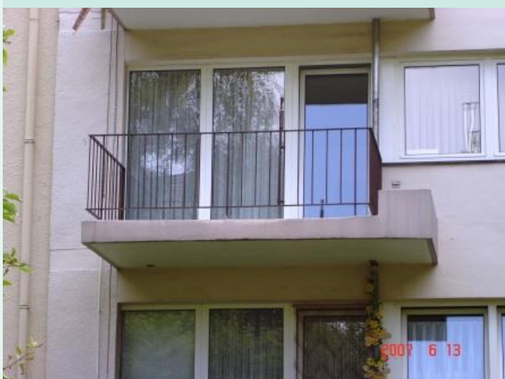
Wärmebrücke: auskragende Balkonplatte
